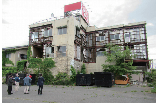
壁面が剥がれ落ちた公費解体申請中の建物(七尾市内)
