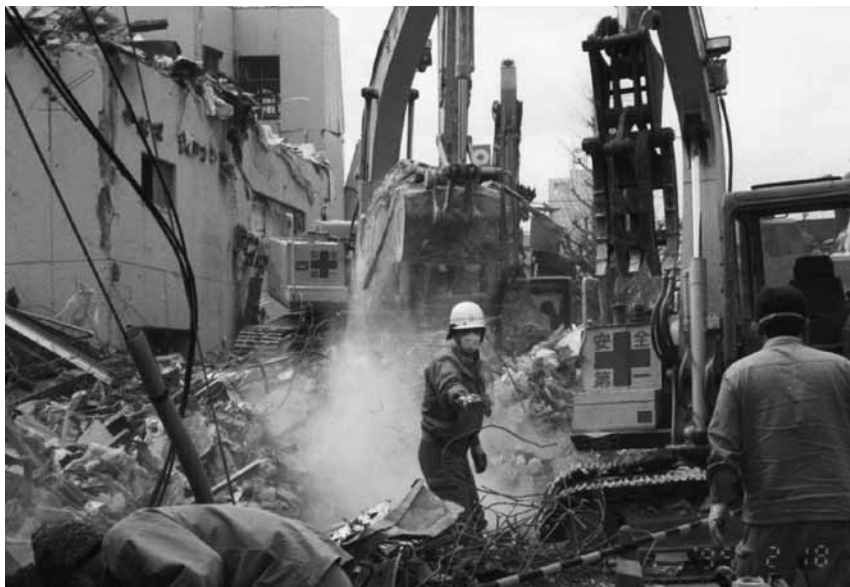
高濃度のアスベストが測定された解体現場
